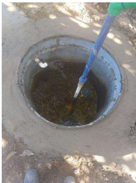
Figura 3. Tanque de almacenamiento del vertimiento con carbón tipo antracita
