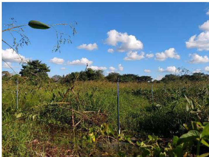
Figura 4. Se instalaron 9 aspersores encargados de distribuir uniformemente el vertimiento sobre el suelo
